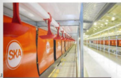
Avec Gemma, les œufs sont pondus dans les pondeurs automatiques, au deuxième niveau.
